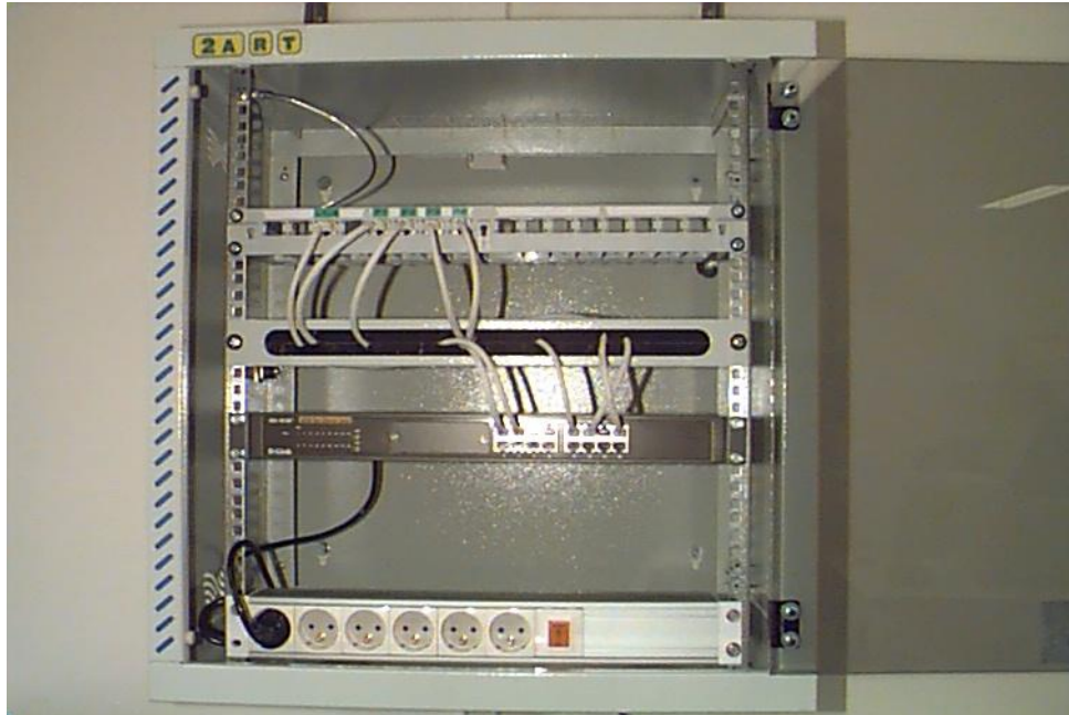
Baie de brassage (SR)
